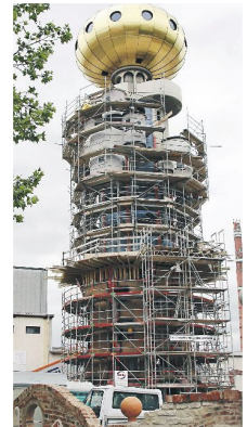
Auch der Abensberger Kuchlbauer Turm steht auf einem vom BGI geprüften Untergrund. Foto: bj
